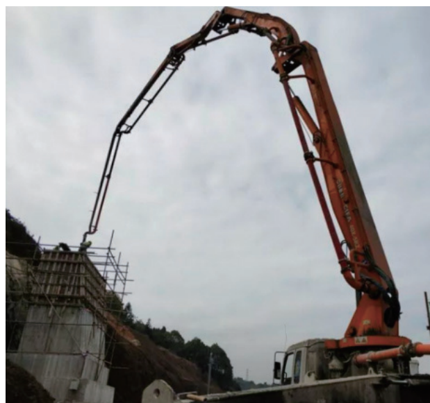
>图1 混凝土车载泵设备
